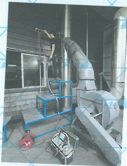
球磨工序废气排放口
